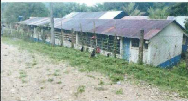
Foto1: Imagen de la lamina deteriorada que necesita cambio
