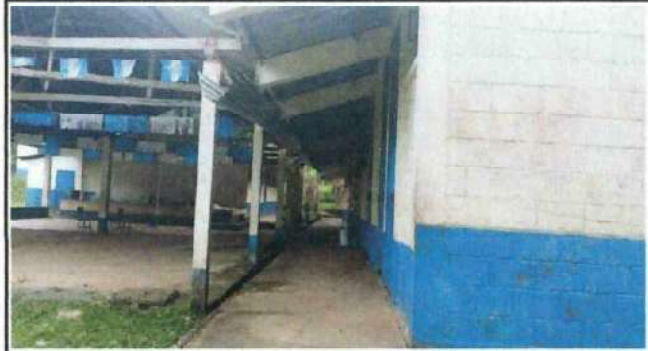
Foto 4: Parte exterior de pared que necesita pintar
